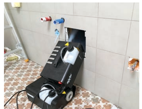
(8) Bei von innen nicht zugänglichen Leckagen wird Theaternebel erzeugt. Die Austrittstellen lassen bei cleverer Anwendung auf Strömungswege schließen.
