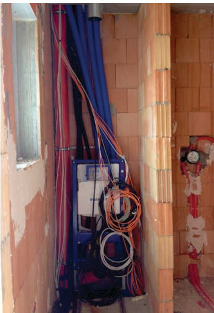
(3) Bei dieser Baustellensituation fehlt der Glattnstrich hinter dem Spülkasten. Dies zeigt sich bei späterer Leckagesuche durch eine Störung an der Druckerklappe.
