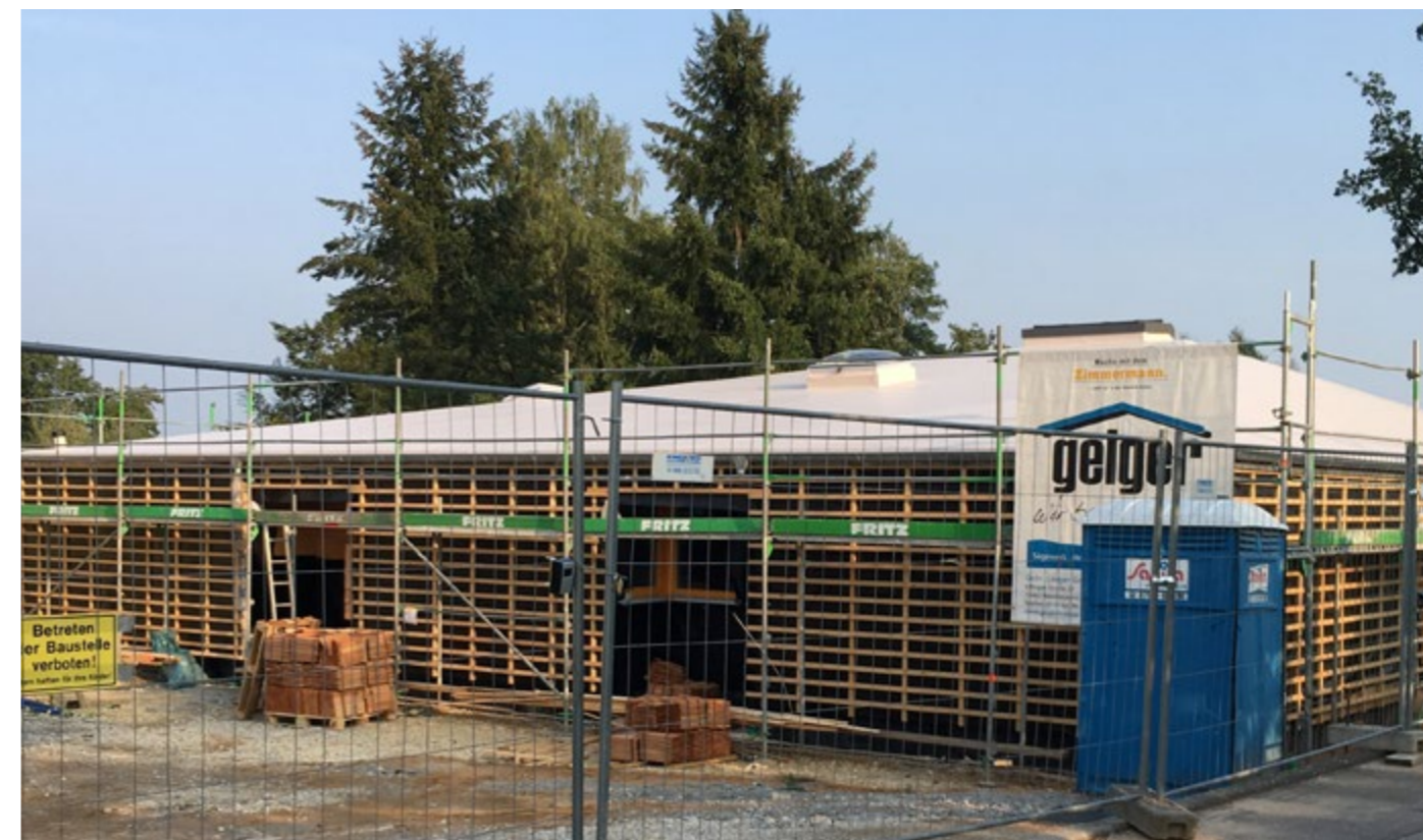
Holzbauer waren schon immer ihrer Zeit voraus. Durch die akribische Detailplanung und Vorfertigung werden viele Fehler eliminiert. Hier eine Kindertagesstätte in Süddeutschland, die in Holzbauweise errichtet wurde. Bildquelle: Bauberatung Franz
